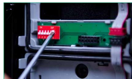
6. CONFIGURARE il tipo di pulsante che verrà utilizzato (singolo/doppio) e un indirizzo al modulo pulsante
